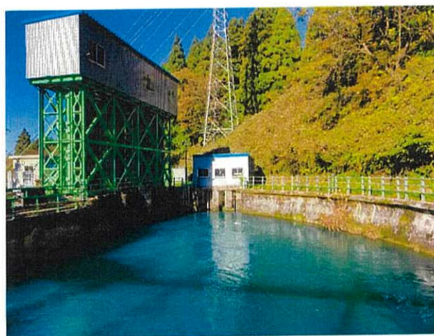
ヘッドタンク (関西電力㈱)
