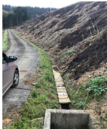
猪被害による法面崩落箇所
