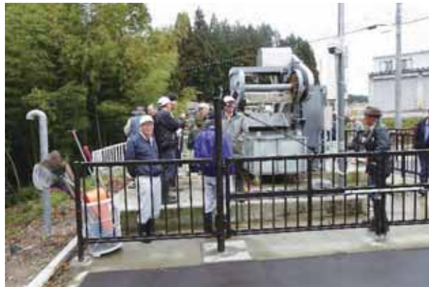
三合新発電ヘッドタンク(三合地内)
