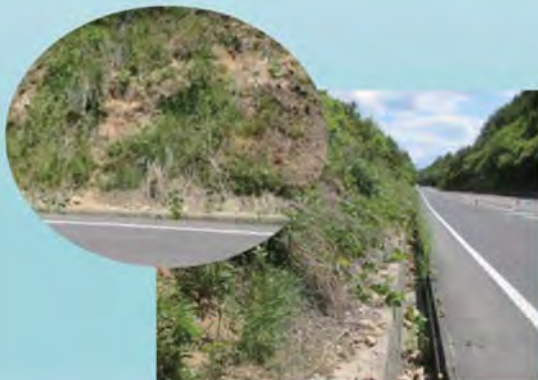
左上: 地肌露出部は猪が掘り起こした跡 右下: 側溝に溜まる落石
