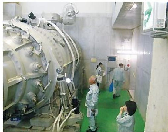
【小摺戸発電所】
