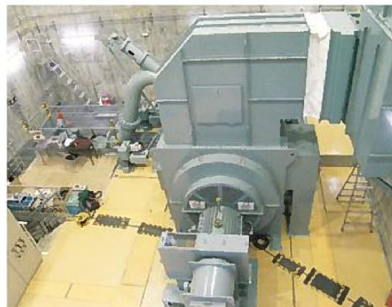
【片貝別又発電所】
