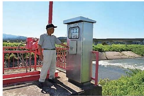
四ヶ村頭首工取水門の操作状況
