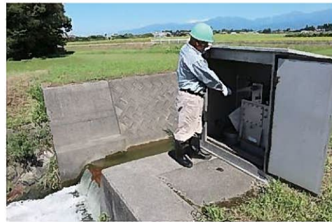
二俣川の取水堰の操作状況
