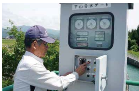
西島 隆雄氏（朝日町） 下山分水ゲートの操作状況
