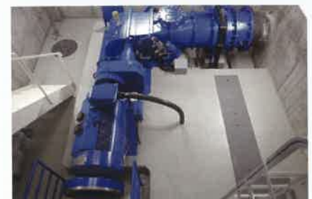
クロスフロー水車・発電機
