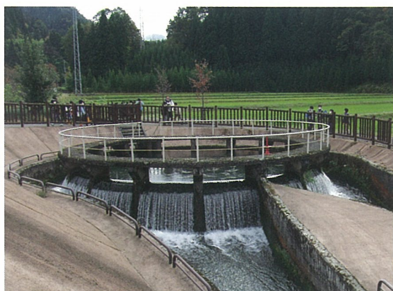
円筒分水槽（上市川沿岸土地改良区提供）
