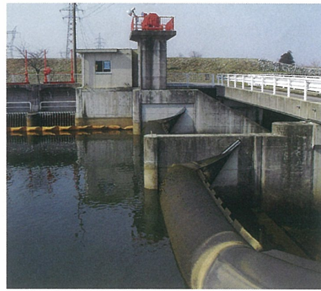
郷川頭首工（下条用水土地改良区提供）
