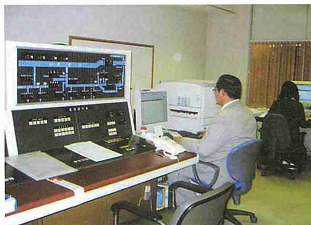
遠隔操作（黒部川左岸土地改良区内）
