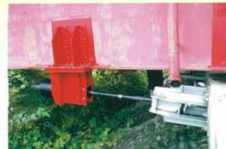
落橋防止装置を設置した橋桁と橋台
