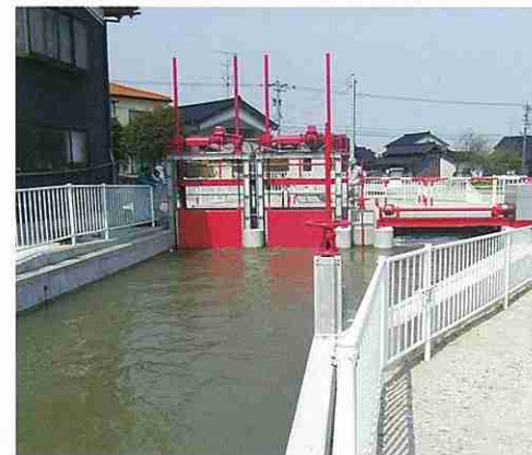
西明寺川サイフォン・放流工（高岡市福岡町上向田地内）
