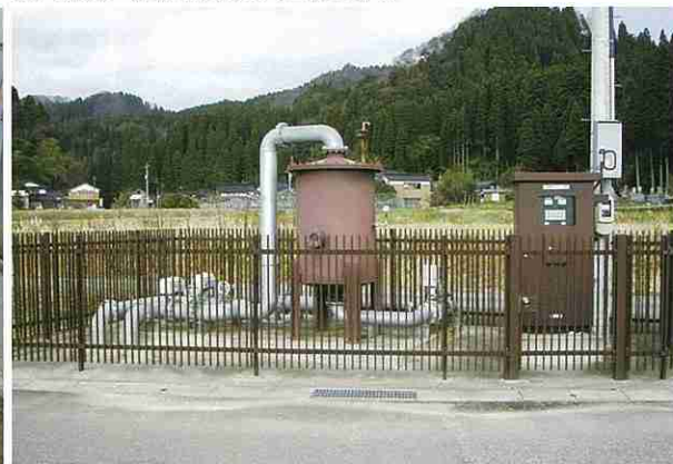
消雪ポンプ（高岡市福岡町加茂地内）
