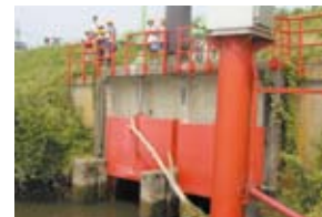
① 取水ゲート 用水路に取り入れる水の 量は、1秒間に約5トン。 (1分間でプール1杯分)
