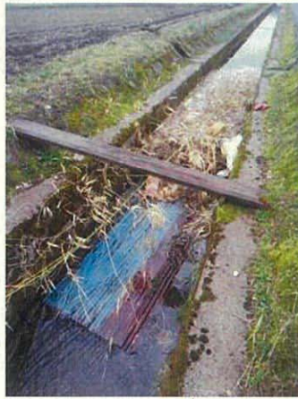
排水路に堆積したゴミ
