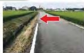
外相線がないと危険です
