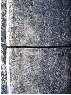
目地材の脱落
