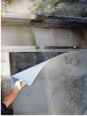
被覆材端部の剥がれ
