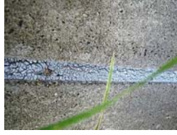
目地材全体に発生したひび割れ
