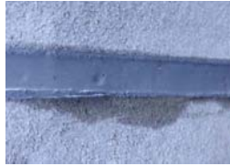
背面水の滲み出し 12
