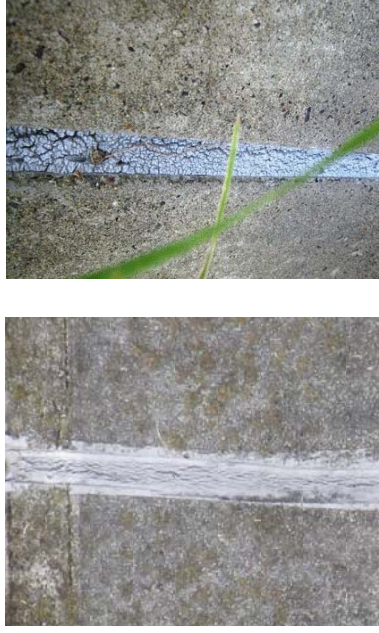
不規則に発生した無数のひび割れ
