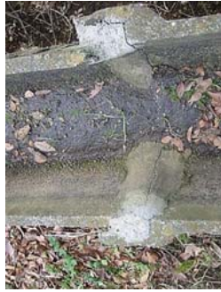
補修後のセメントモルタルのひび割れ
