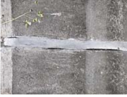
目地材の剥離 (付着切れ)
