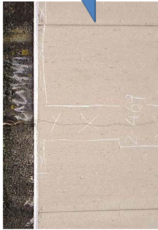
パネル中央に発生したひび割れ
