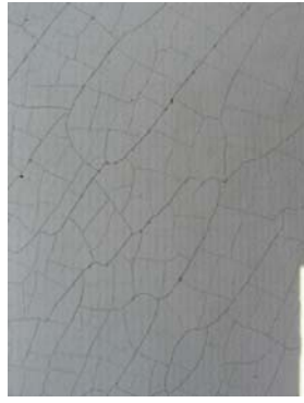
網の目状に発生したひび割れ
