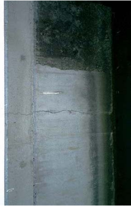
嵩上げコンクリートまで繋がるひび割れ
