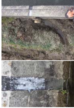
写真1 シーリング材劣化による漏水
