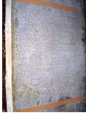
網の目状に発生したひび割れ
