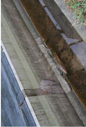
被覆材の剥がれ
