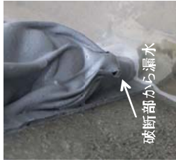
側壁部の膨れ・破断
