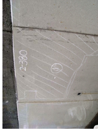
パネルに発生した浮き
